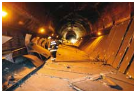
Рис. 2 Обрушение подвесных плит в тоннеле Сасаго, Япония, 2012 г.
