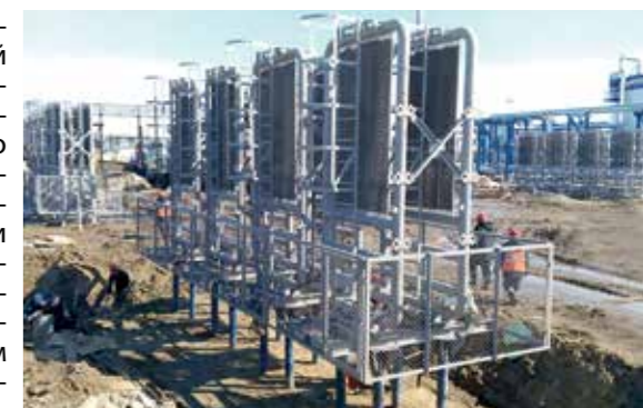
Обустройство Новопортовского месторождения. Резервуары нефти РВС-10 000 м³.
