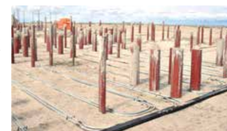
Охлаждающие системы ГЕТ в основании Компрессорного цеха Новопортовского НГКМ
